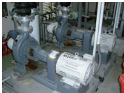
暖房用温水循環ポンプ
