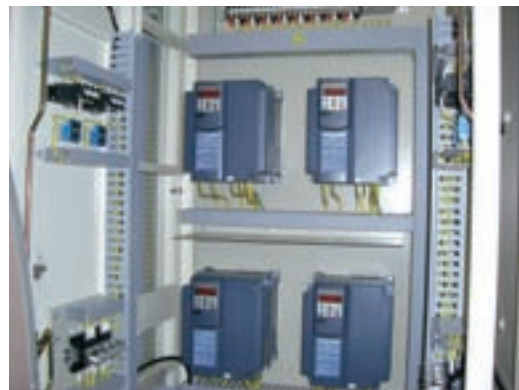
インバータ制御盤
