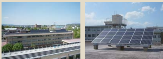
学生センター屋上太陽光発電パネル
