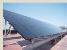
学生センター屋上太陽光発電パネル
